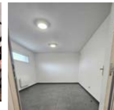
Réfection complète des vestiaires au stade Bailleux. Une dalle est en cours de création à l'extérieur du bâtiment.
